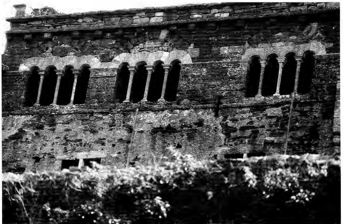
217. PRUDHOMAT (Lot) : Château de Castelnau-Bretenoux. Claire-voie sous arc de décharge de la tour-salle (début XIII e siècle).
